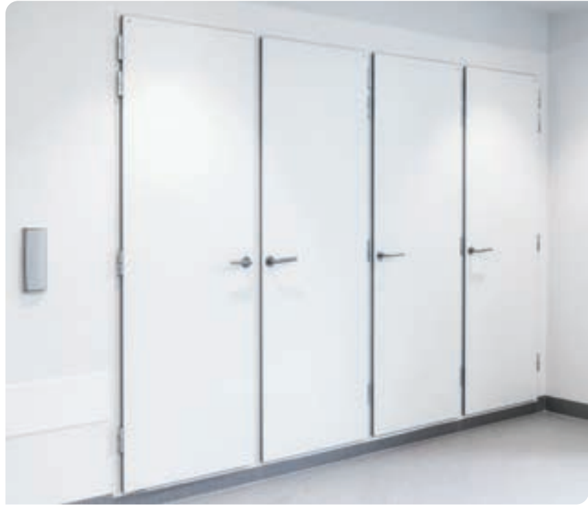
Bleibeschichtete, feuergeschützte modulare Durchreiheschränke 40/60, von der Außenseite des OP-Saals aus gesehen
